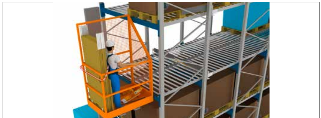
Figura 41: Carretilla elevadora sin suficiente carrera lateral (< 150 mm en cada sentido) y cesta de mantenimiento con vallado en la zona de peligro
